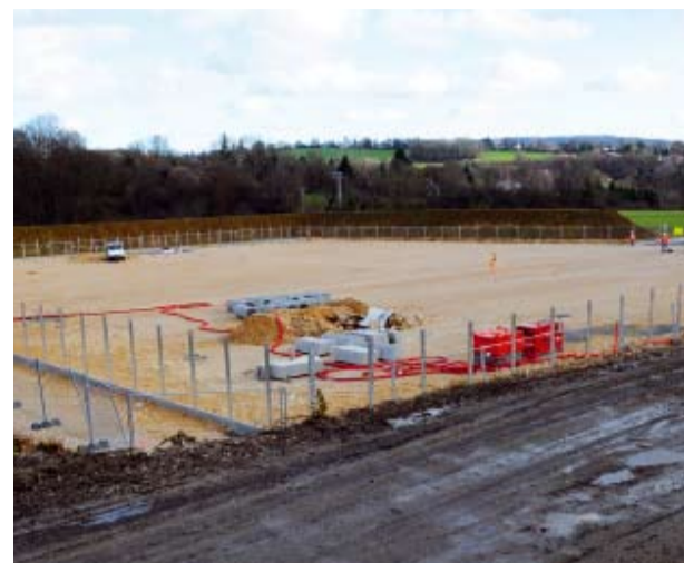
► Plateforme de la sous-station - Besançon
